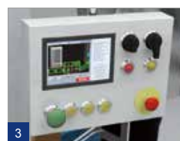
Dispositivos de mando, accionamiento y señalización
