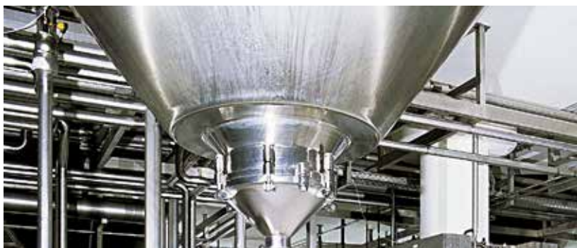
Tanques y contenedores
