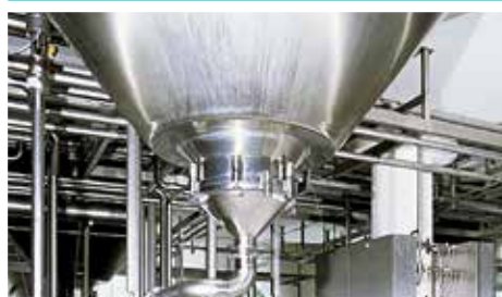
Tanques y contenedores
