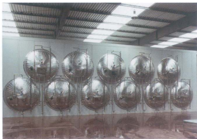
Cantine GIACOBazzi - Nonantola (MO) - Impianto autoclavi orizzontali. GIACOBazzi Winery - Nonantola (MODENA) - Horizontal pressure tanks system.
