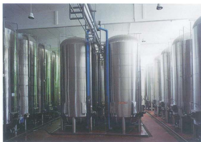
RICCADONNA - Canelli (AT) - Impianto autoclavi in acciaio inox. RICCADONNA - Canelli (ASTI) - Stainless steel pressure tanks system.
