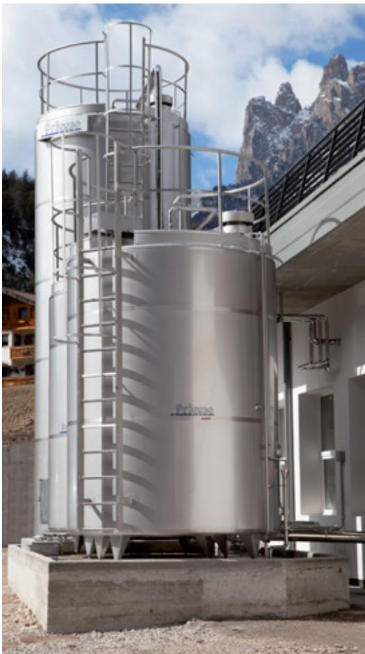
▲ Serbatoi di stoccaggio
