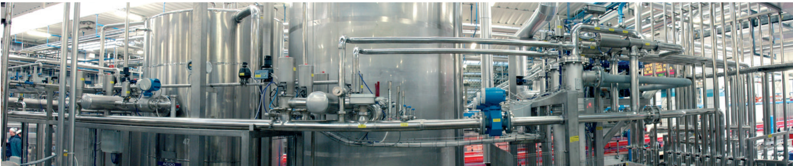
▼ Impianto CIP CIP plant
