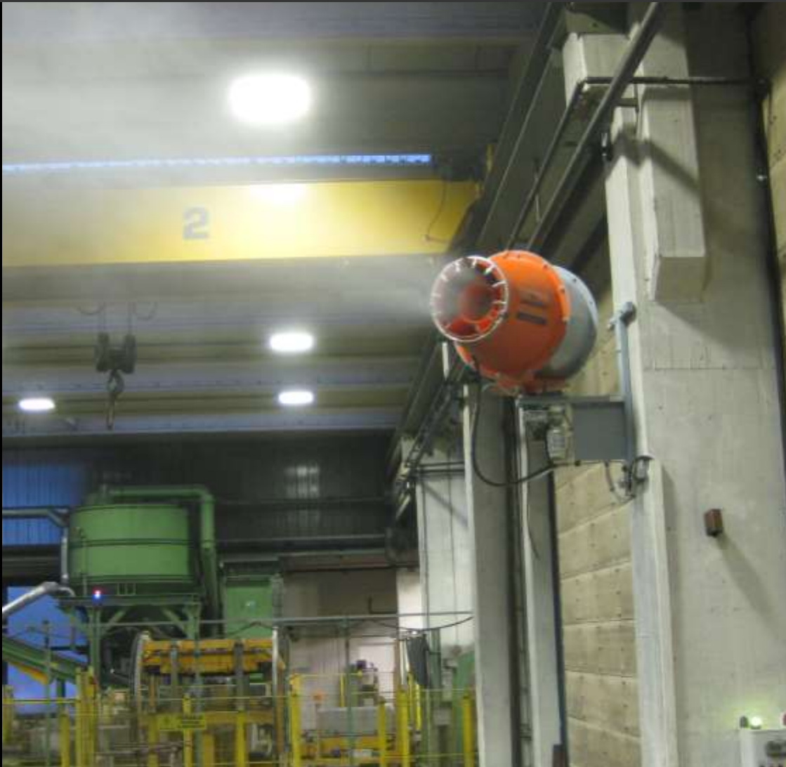
Cañón Big Fogger montado sobre pared y sobre ruedas para el abatimiento de olores
