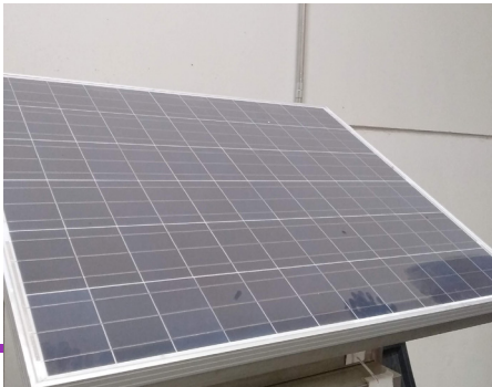
Placa solar (capacidad de las placas, de 5,5 a 8,5 KW)
