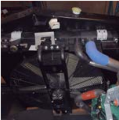
Sistema de enfriamiento hidráulico/motor/climatizador/intercambiador/caja de transferencia reversible y programable
