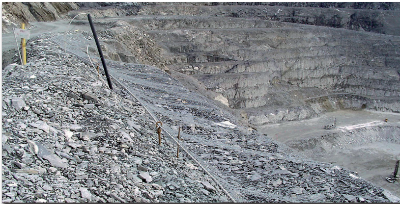
Malla DT contra caída de rocas Porcupine Joint Venture, Canadá
