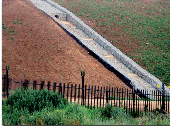
Canaleta de desagüe con gaviones, Australia
