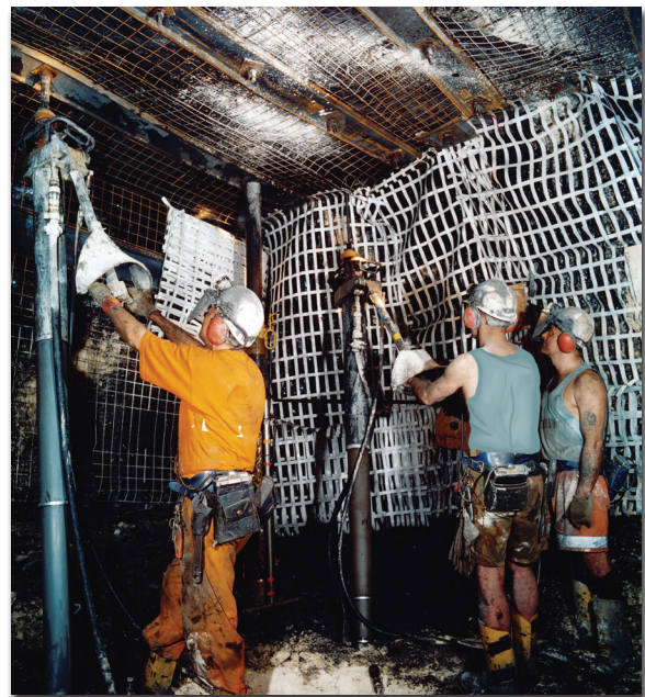
Control de derrubios con Pararib™ Mina de carbón, Yorkshire, UK*
