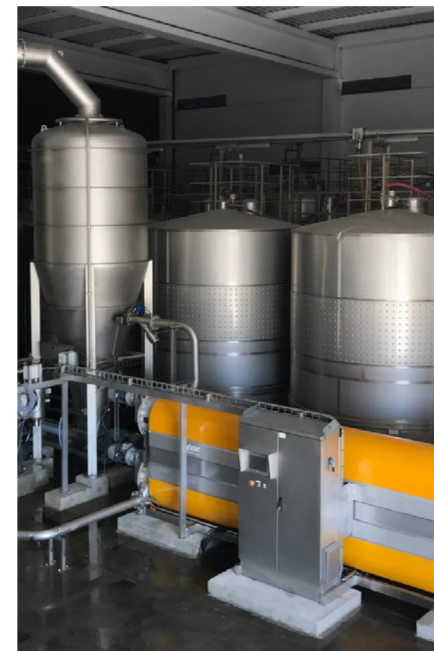
Cámara de expansión de 20 t/h con condensador
