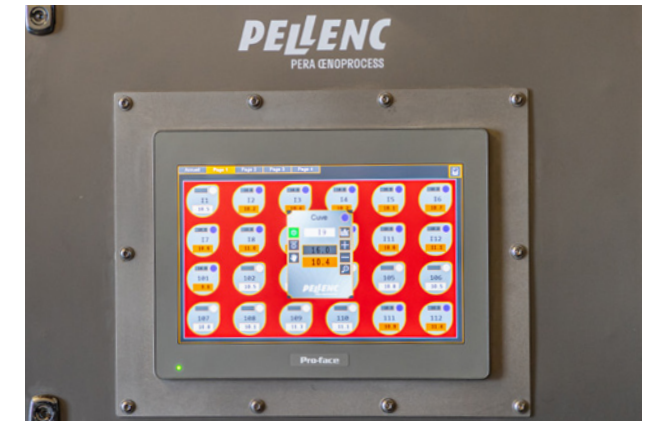
Interfaz de control de una termovinificación con Flash Détente
