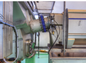
Alimentación directa a la despalilladora
