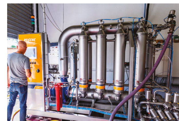
FILTR'ACTIV T160 y bombas de alimentación
