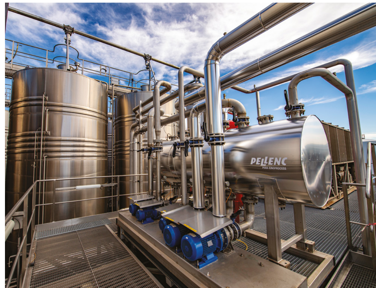
Acumulador intermedio y gestión de la distribución térmica
