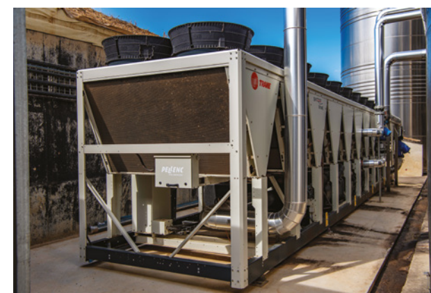
Grupo de producción de frío con recuperación de calor
