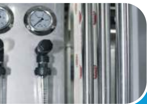
TUBERIAS DE ACERO INOX, SISTEMA PRESS FITTING
