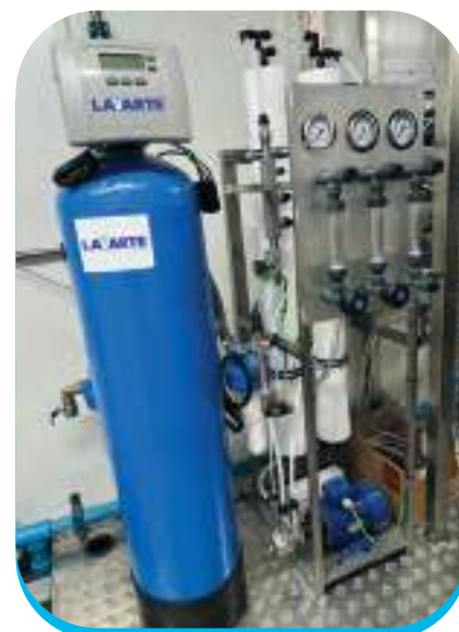
PLANTA DE OSMOSIS
