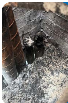
Situation des tuyaux de descente diamètre 110 mm des étages touchés par l'incendie à l'étage dans lequel l'incendie a eu lieu
