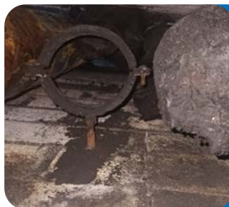
Vue d'une autre descente affectée, dont le tuyau installé s'est complètement fermé
