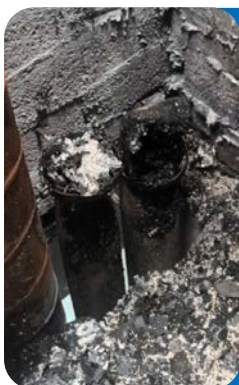
Vue rapprochée des tuyaux de descente affectés : on peut constater l'expansion vers l'intérieur qui permet d'empêcher la propagation de la fumée, et la partie extérieure seulement noircie par le feu
