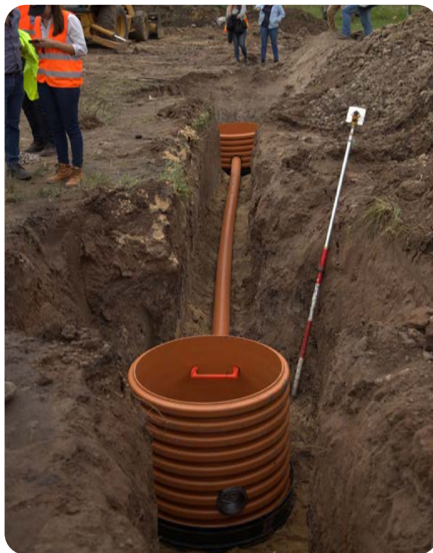
Réseau d'assainissement à Tobatí- Cordillera (Paraguay)
