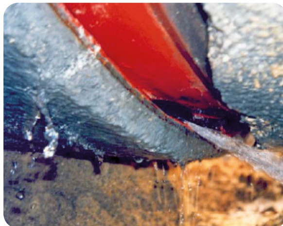
Fuga por la unión en tubería de hormigón
