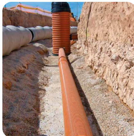
Colector y pozos SANECOR® para aguas residuales junto a colector de pluviales en hormigón
