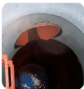
Falta de estanqueidad en pozos de hormigón
