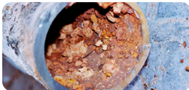
Tubería de saneamiento con deposiciones de material
