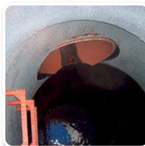
FALTA DE ESTANQUEIDAD EN POZOS DE HORMIGÓN.
