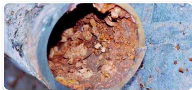
TUBERÍA DE SANEAMIENTO CON DEPOSICIONES DE MATERIAL.
