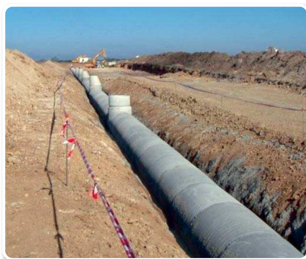
COLECTOR DE HORMIGÓN ARMADO.
