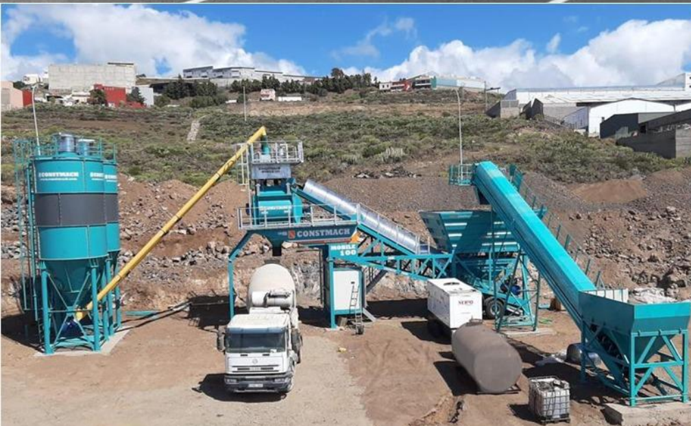
Con silos externos y sistema de llenado de tolvas
