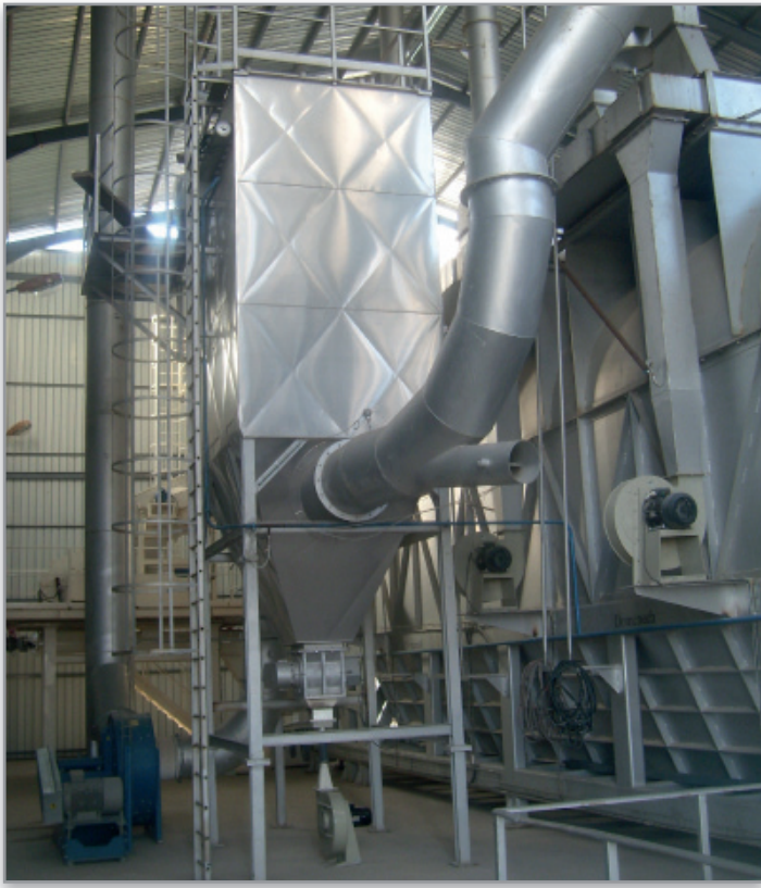
Filtro de mangas / Baghouse
