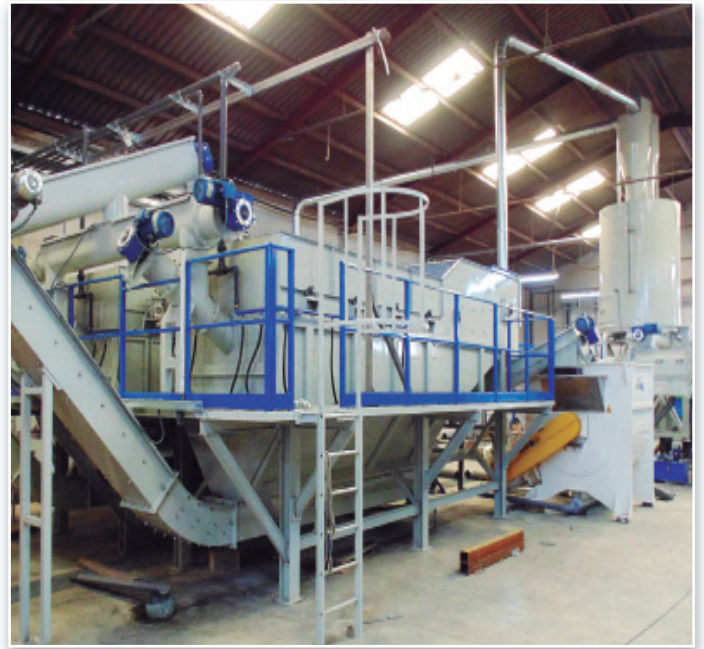
Tinas de lavado en paralelo/ Sink float tanks in parallel
