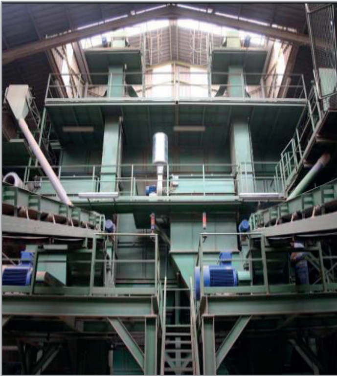
Instalación para Cerámica / Ceramic plant
