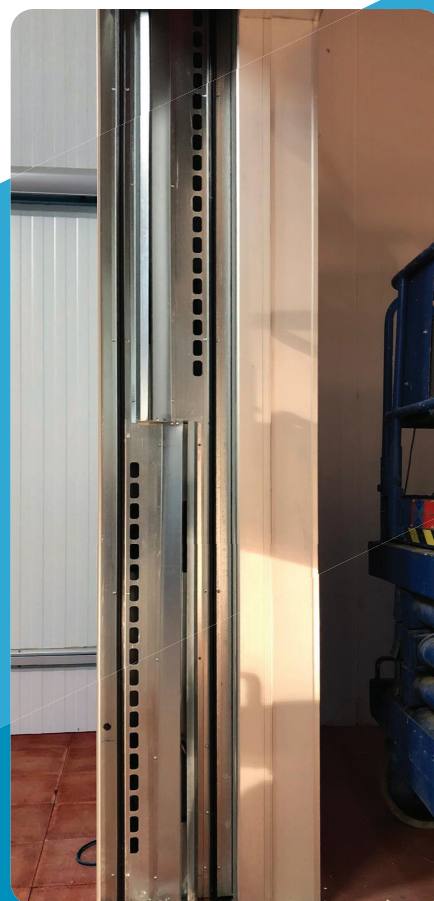
Detalle sistema AIR en Frigo 2
