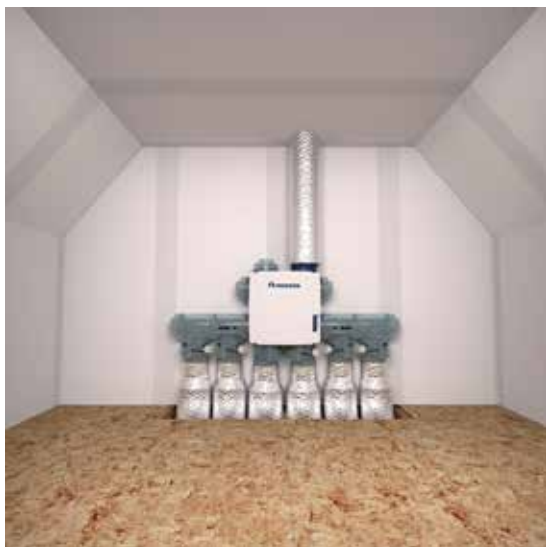
Múltiples conductos hacia abajo
