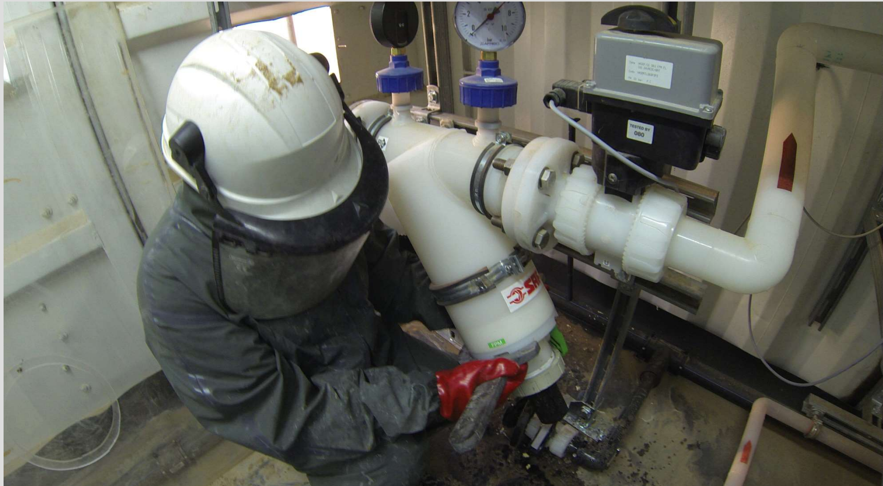
Línea de ácido sulfúrico al 98% en una mina de Uranio - AREVA
