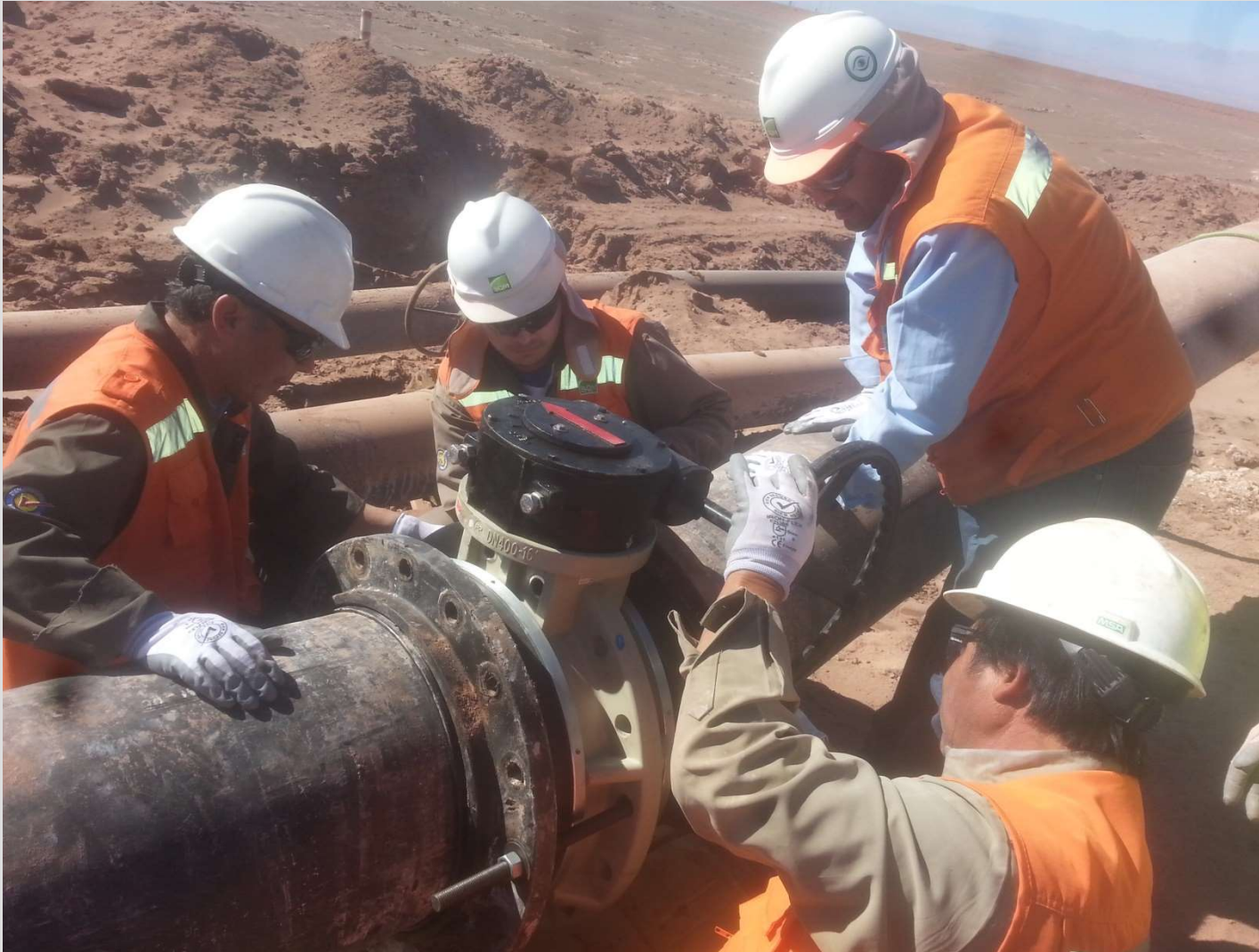
Línea de ácido sulfúrico para aplicación de lixiviación por pilas en una mina de cobre, CODELCO
