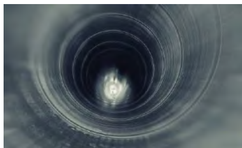
Conductos de climatización
