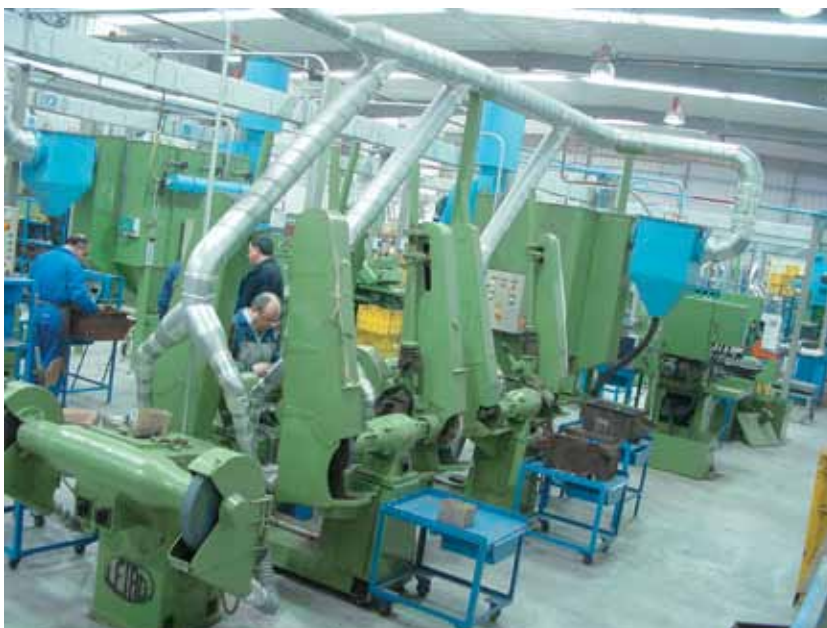
Instalación de aspiración y depuración de diferentes puestos de esmerilado y pulido.
