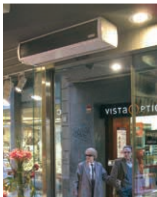
OPTIMA Instalación en un centro comercial
