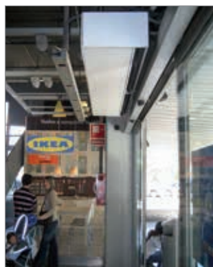
WINDBOX Instalación vista en un hipermercado
