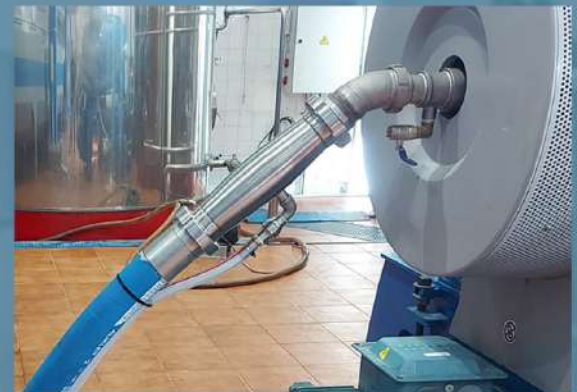
Aportador de agua a la entrada del decanter horizontal
