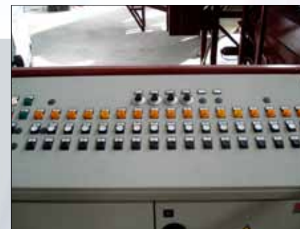
consolle di comando | control panel
