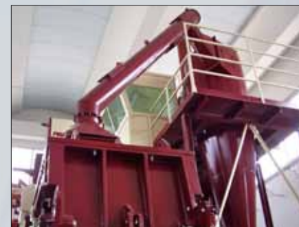
impianto di aspirazione
