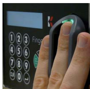
Lectores de Huellas
