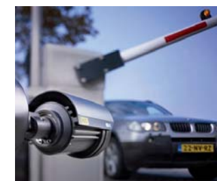
Control de Acceso Vehicular
