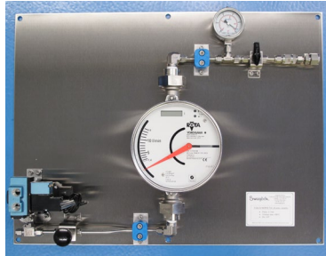
Panel de regulación de suministro
