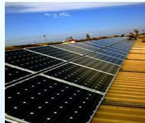
Planta solar fotovoltaica de 30 kW sobre cubierta en nave industrial
