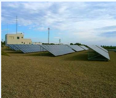
Planta solar fotovoltaica de 100 kW en la EDAR de Pilar de la Horadada
