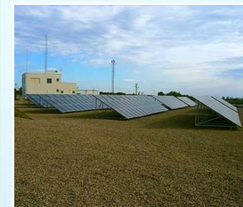
INTEGRACIÓN FOTOVOLTAICA 100 kW EDAR PILAR DE LA HORADAD
