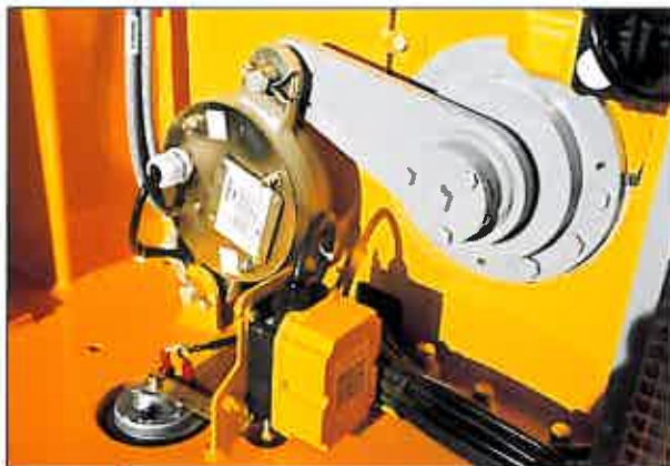
Seguridades electromecánicas y finales de carrera
