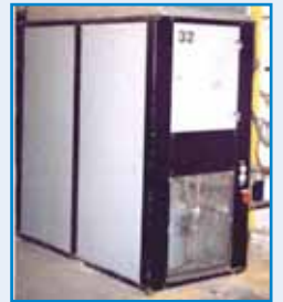
Equipo refrigerador Coolant equipment
