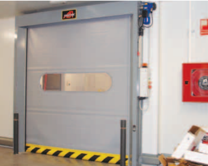
Instant Roll® instalación frigorífica.
