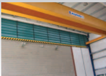
Puerta rápida puente grúa.
