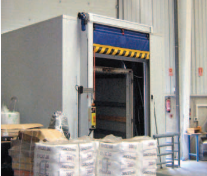
Puerta rápida con cerramiento en muelle de carga.
