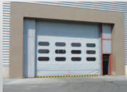
Puerta rápida en nave industrial.
