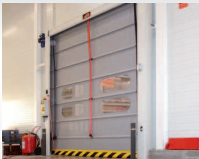
Instant Pass® LACADA en almacén de supermercado.
