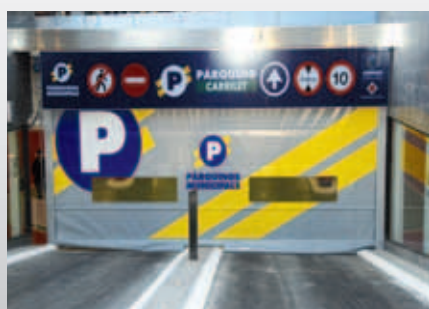
Puerta rápida acceso parking.
