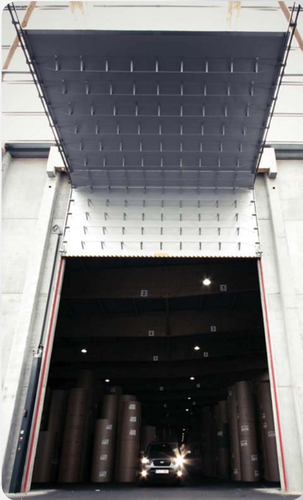
Puerta cortafuegos de grandes dimensiones
