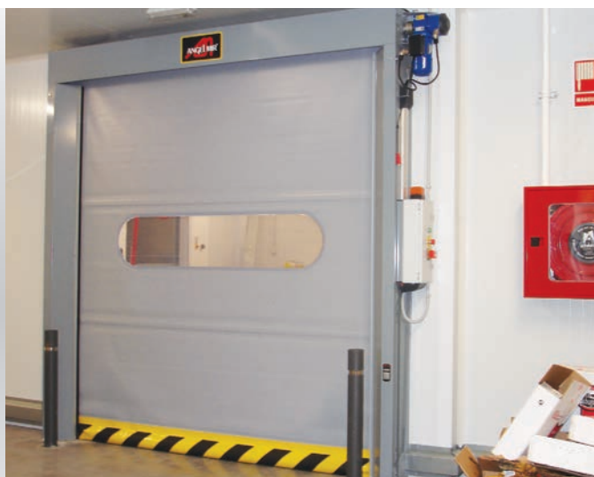
Instant Roll® instalación frigorífica.
