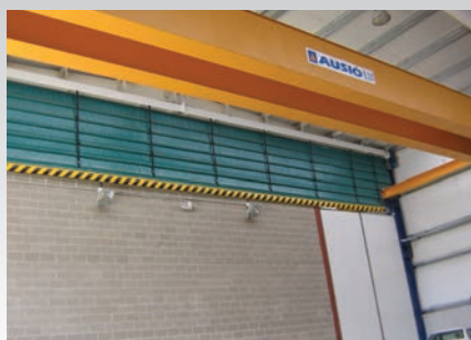
Puerta rápida puente grúa.
