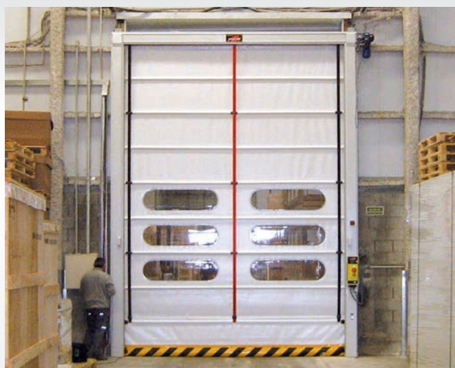
Instant Pass® LACADA en almacén de supermercado.
