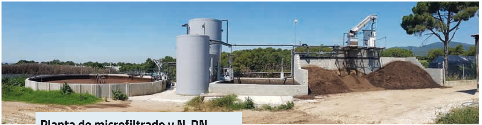
Planta de microfiltrado y N-DN
