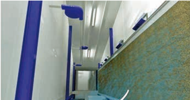
Entradas de ventilación bodega inferior bandejas.
