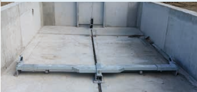
Sistema de limpieza de canales
