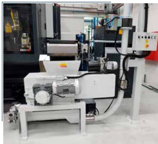
Stazione di aspirazione dotata di trituttore per trucioli di acciaio
