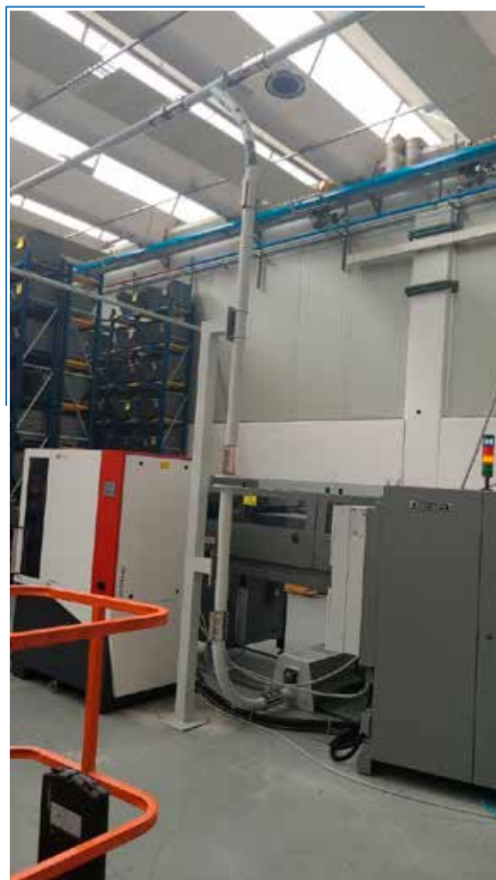
Stazione di aspirazione sotto macchina utensile
