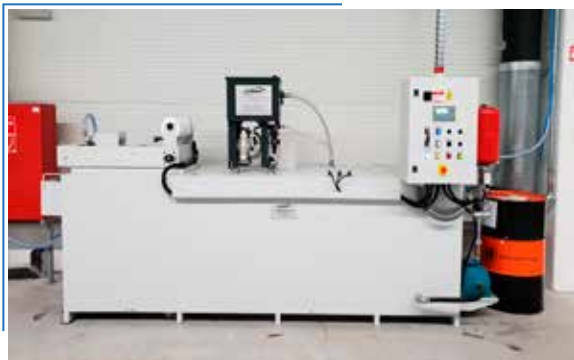
Sistema centralizzato di filtrazione per emulsioni dotato di filtro a carta, disoleatore e sistema di dosaggio e rilancio
