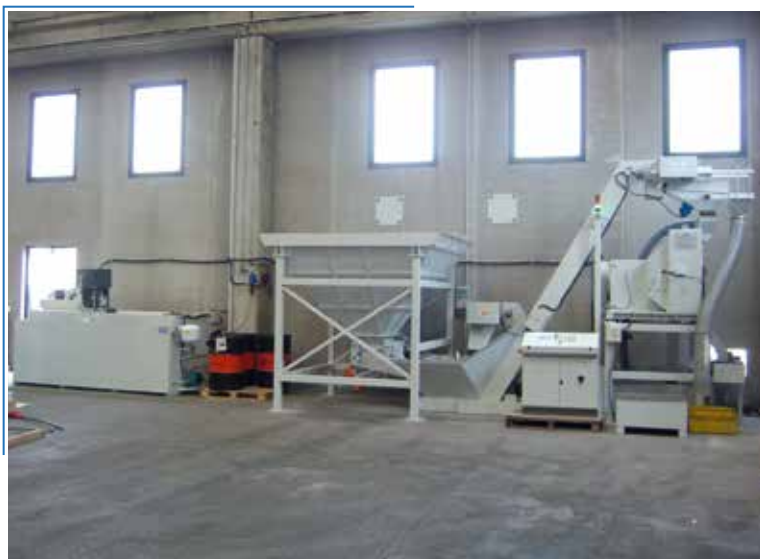
Sistema di centrifugazione con tramoggia di prestoccaggio di 6m 3
