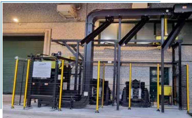
Due stazioni di scarico, doppia centrifugazione, triturazione e containerizzazione di ottone ed inox
