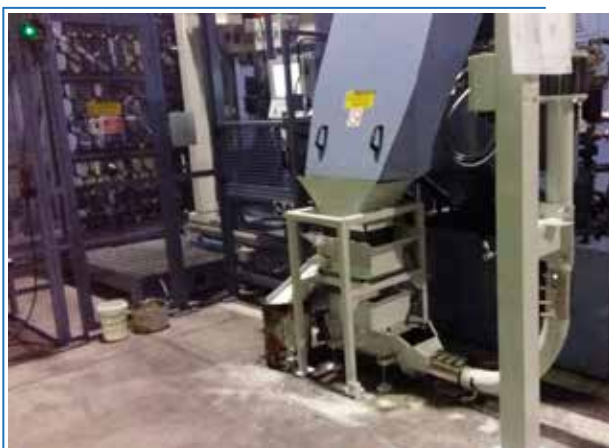
Stazione di aspirazione dotata di vibrovaglio per l'espulsione di pezzi
