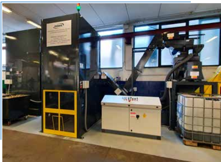
Dettaglio della zona di recupero del refrigerante dalla separazione dei trucioli
