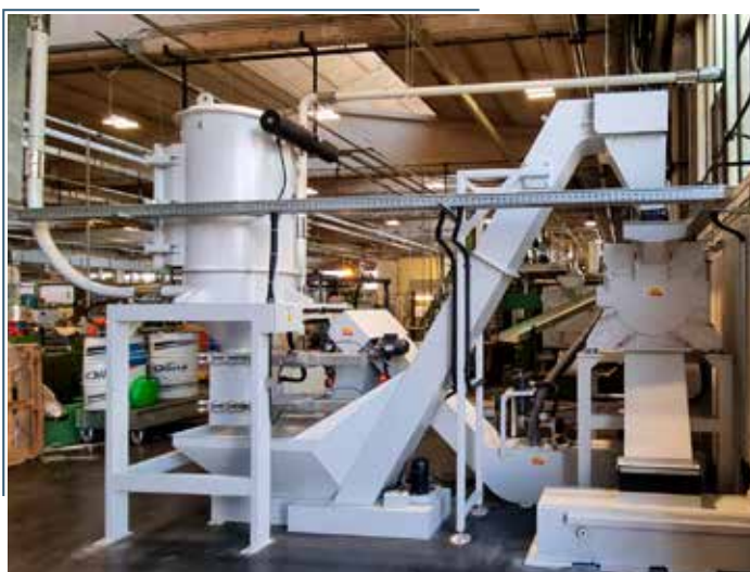
Ciclone con scarico in impianto di centrifugazione e trasporto pneumatico trucioli
