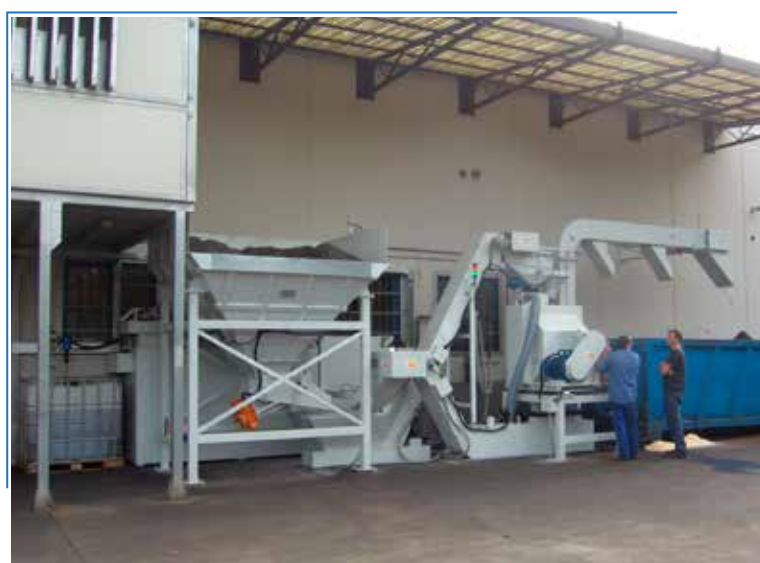
Impianto di centrifugazione e containerizzazione
