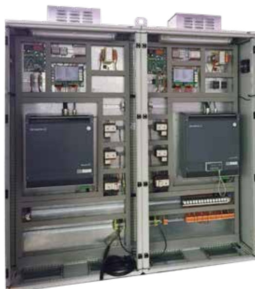
Instalación especial ATEX con doble maniobra para industria química
