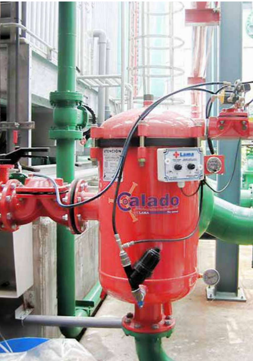
Ubicación / Location: China Origen / Origin: agua de proceso / process water Caudal / Flow: 50 m 3 /h Luz de paso / Pore size: 50 μ Descripción / Description: intercambiadores / cool-heat exchangers
