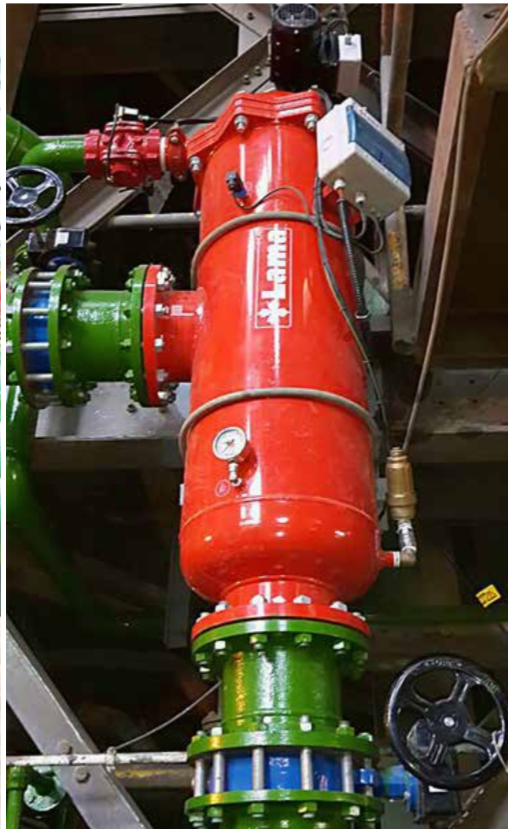
Ubicación / Location: Iran Origen / Origin: agua de torre de refrigeración / cooling tower Caudal / Flow: 200 m 3 /h Luz de paso / Pore size: 115 μ Descripción / Description: refrigeración de una industria metalúrgica Colling proces for a metallurgy industry
