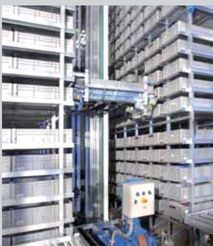
Almacén miniload automatizado (miniload)
