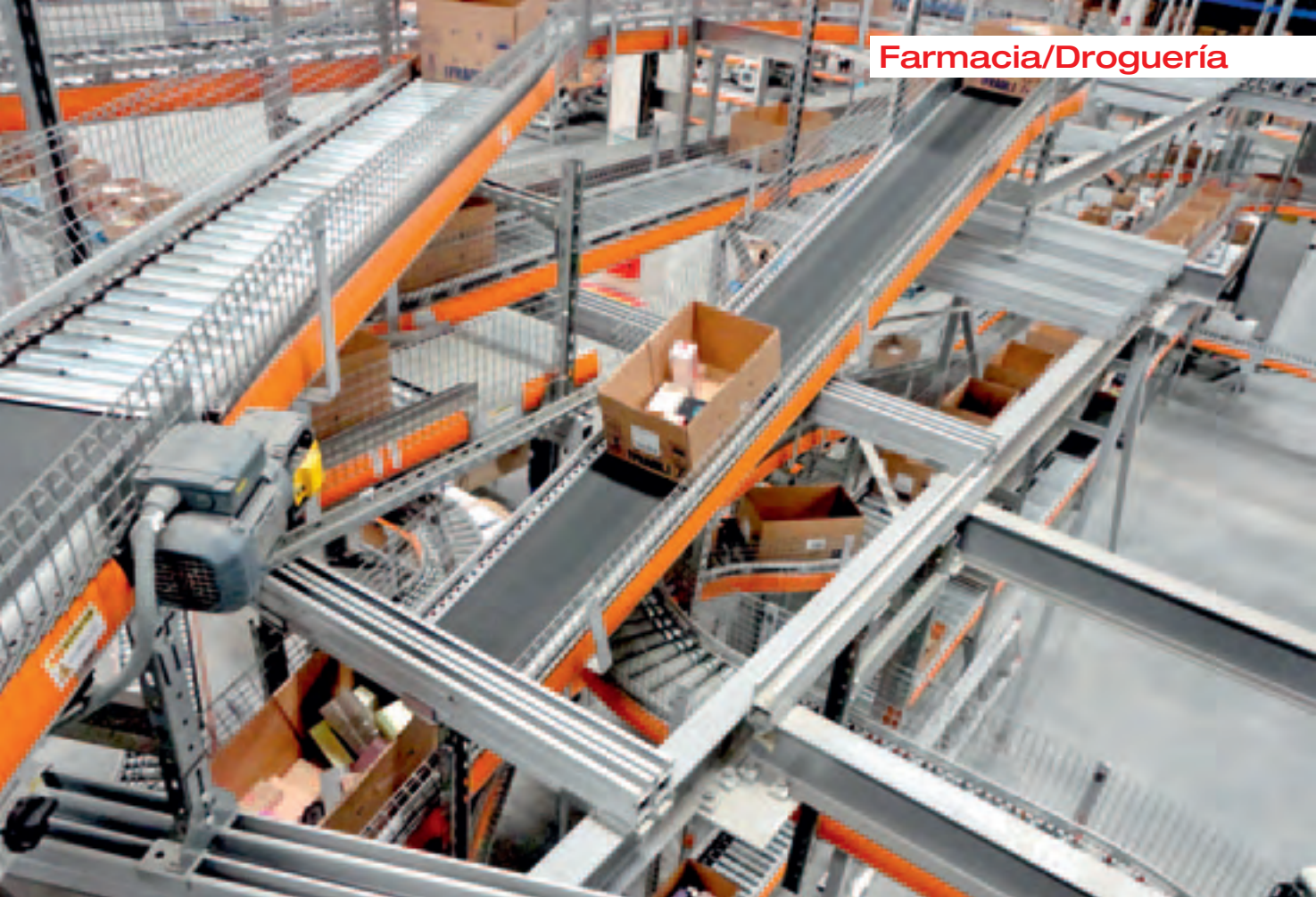
Un complejo sistema de transporte de material traslada los artículos en el centro de distribución
