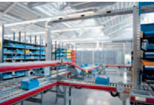
SSI Schaefer instaló un sistema de transporte con nueve ramales
