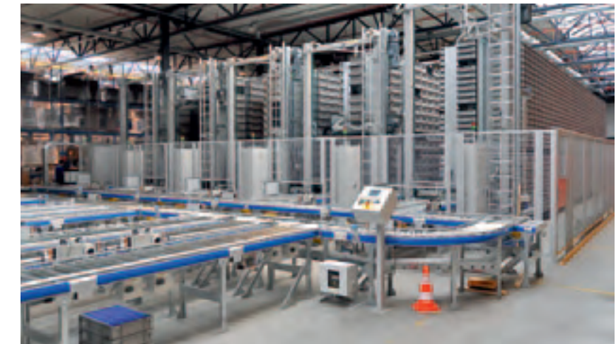
La instalación del SCS incluye cinco carruseles con 80 soportes cada uno.
