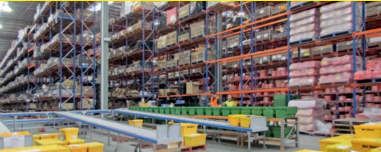
Enlace del sistema de transporte a la zona de preparación de pedidos
