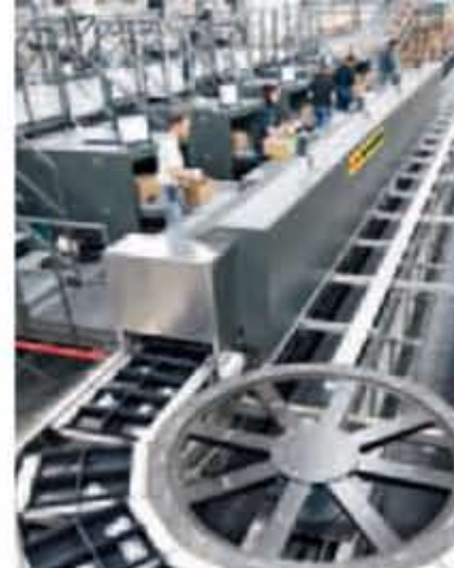
Sistema pick-to-bucket: A cada ubicación de picking se le ha asignado un sistema de recogida con 16 tolvas.
