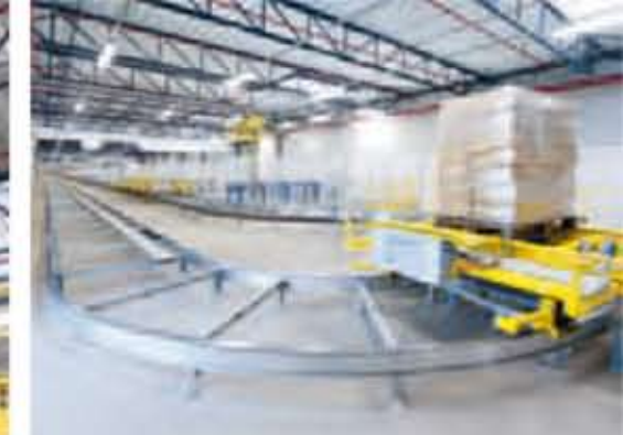
La electrovía de palets (EPB) aprovisiona los almacenes de gran altura
