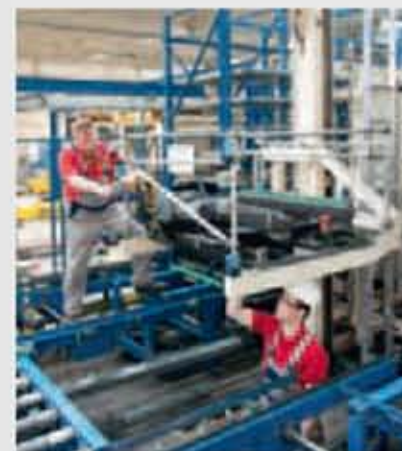
Todos los componentes del transelevador excepto el mástil y el pórtico del testero han sido desmontados
