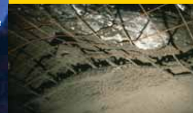
Hormigón proyectado. Huecos detrás de las armaduras/Rebote de proyección. 2
