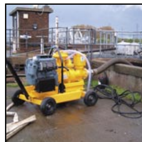
Estación depuradora de aguas residuales (UK)
