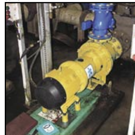
Estación depuradora de aguas residuales (UK)
