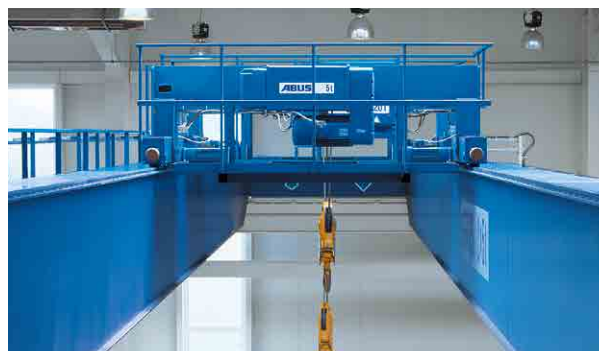
El mantenimiento es aún más fácil, para grandes poli- pastos y carros anchos, con esta pasarela transitable: el polipasto eléctrico de cable ABUS del tipo DB.
