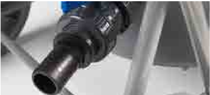
Bomba extractora de drenaje.
