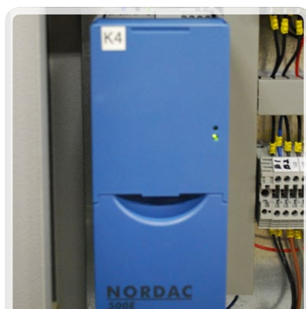
Variador de frecuencia
