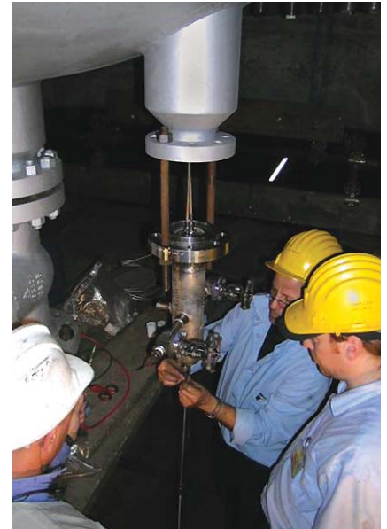
Instalación de un termopar multipunto
