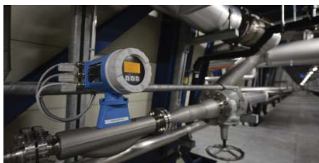
Promass utilizado para medir por efecto Coriolis la densidad durante el proceso de acondicionamiento de fangos
