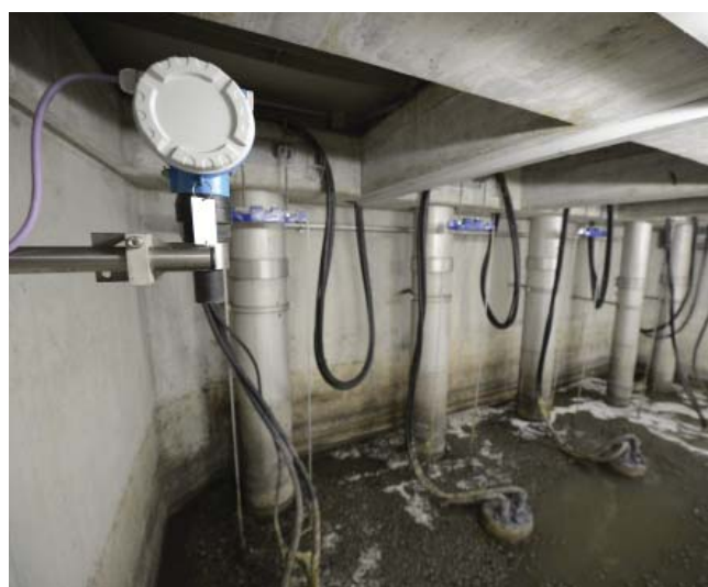
Medición fiable de nivel en una red extensa de alcantarillado
