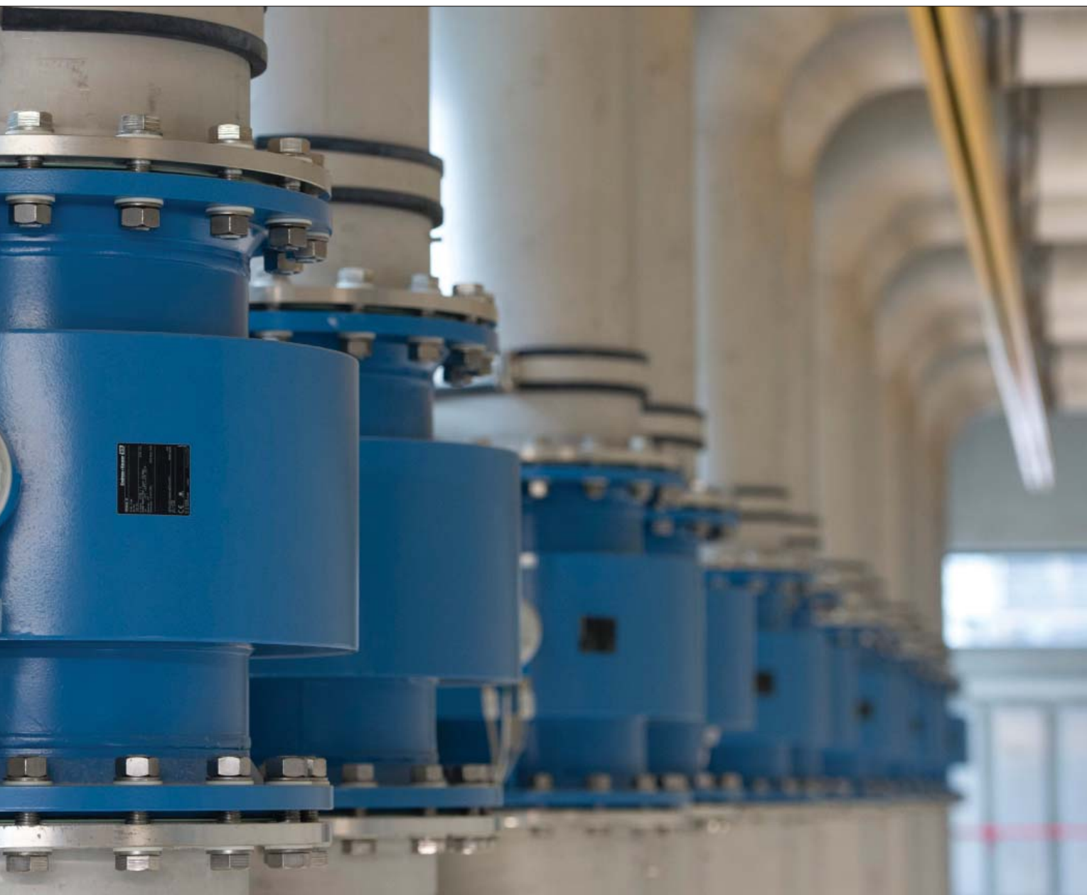
Medición del caudal de agua, aguas residuales o fango: el procedimiento de inducción magnética es el que se utiliza normalmente para medir el caudal
