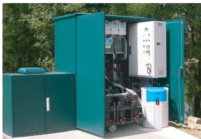
Estación compacta para la monitorización de la reserva natural de agua incluyendo container
