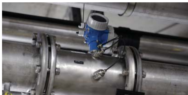
Medición ultrasónica del contenido de metano en biogás y del caudal con el Prosonic Flow B 200
