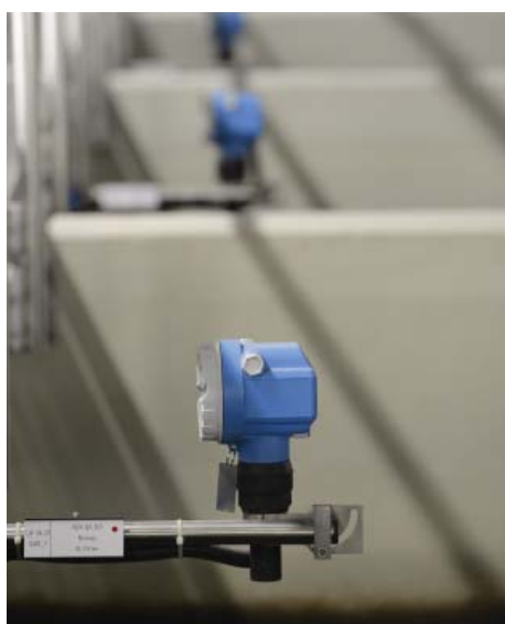
Monitorización fiable del nivel en balsas
