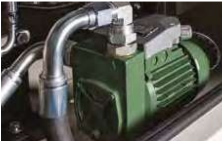
Bomba de trasiego de combustible
