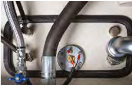
Depósito de combustible
