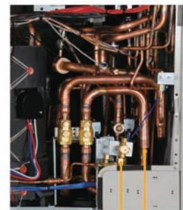
Tubería de líquido Tubería de gas
